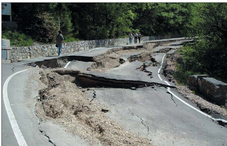
Рис. 1. Пример оползневого повреждения участка автодороги
