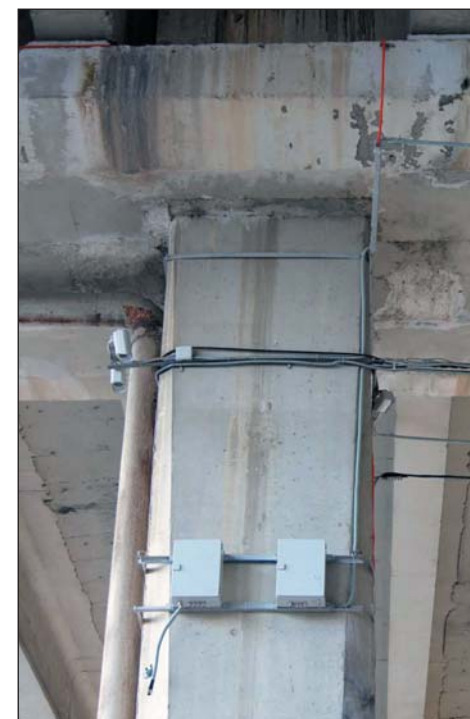
Рис. 6. Шкафы с телематическим оборудованием, смонтированные на 10-й опоре Хостинской эстакады
