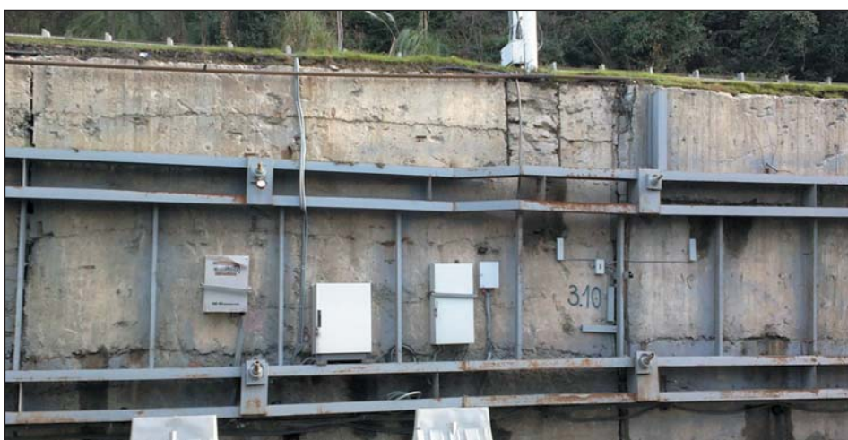
Рис. 5. Оборудование АПК, смонтированное на пилотном объекте СКДС (слева — монтажные шкафы с телематическим оборудованием объектового комплекса, справа — датчики относительного смещения элементов конструкции противооползневой сооружения)
