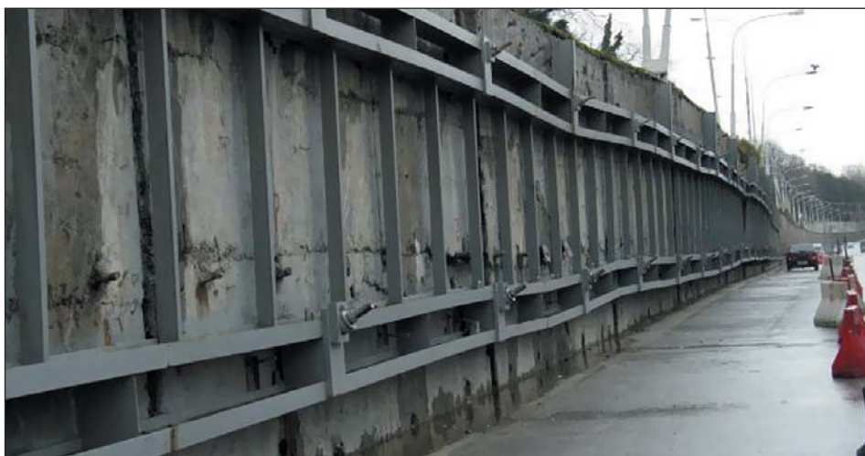
Рис. 4. Противооползневые сооружения, смонтированные на трассе Джубга — Сочи (будущие пилотные объекты АПК СКДС)
