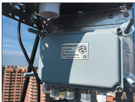
Рис. 4. Базовая станция RisingHF RHF2S008, установленная на объекте
