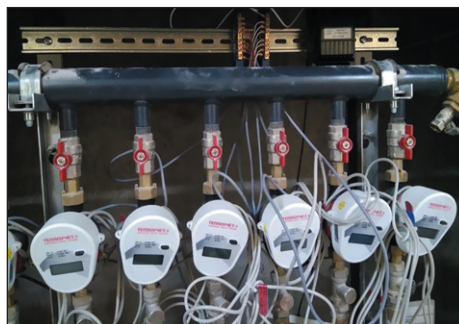
Рис. 7. Коллекторный шкаф с установленным преобразователем
